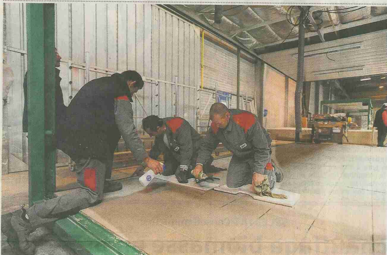
Les modulaires de la société Jipé sont complètement habillés. Ici les techniciens installent du carrelage. PHOTOS DNA — JEAN-PAUL KAISER
